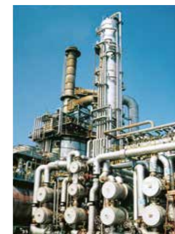
常圧蒸留装置 原油を蒸留し、LPG・ナフサ・灯油・軽油・残渣油の各留分に留留します。
