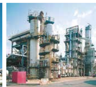
水素化分解装置 減圧蒸留装置で残渣油から分留された減圧軽油を、水素ガスと混合し、高温高圧雰囲気中で触媒と反応させ、高品質のナフサ・灯油・軽油を製造します。
