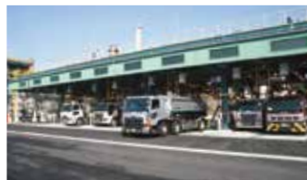
四国事業所 陸上出荷設備
