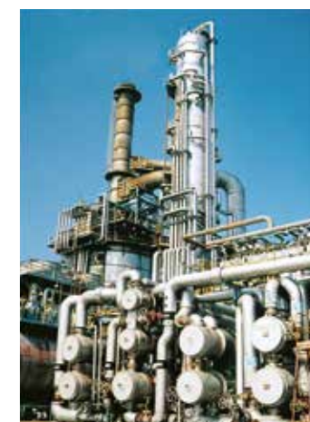
常圧蒸留装置 原油を蒸留し、LPG・ナフサ・灯油・軽油・残渣油の各留分に留留します。
