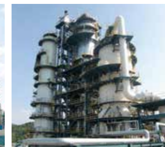
残油流動接触分解装置 原料である重油を高温低圧雰囲気中で触媒と接触させることで分解し、プロピレン・LPG・ガソリン留分を製造します。
