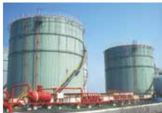
原料・製品貯蔵設備
